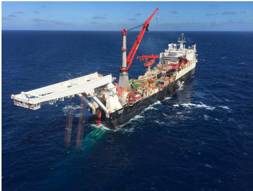
Solitaire har startet med at anlægge rør i den finske golf den 5. September 2018
